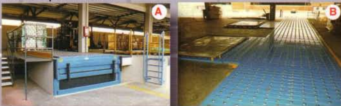
17 Piattaforma elevatrice con piste a sfera, impianto di pesatura elettronico e sistema di tappeti a sfera per la preparazione e il carico di pallets aerei.
